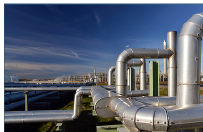
Abb. 5: ... Rohrleitungen können Lärm verursachen, ...
